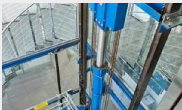
Sistema hidráulico elevador
